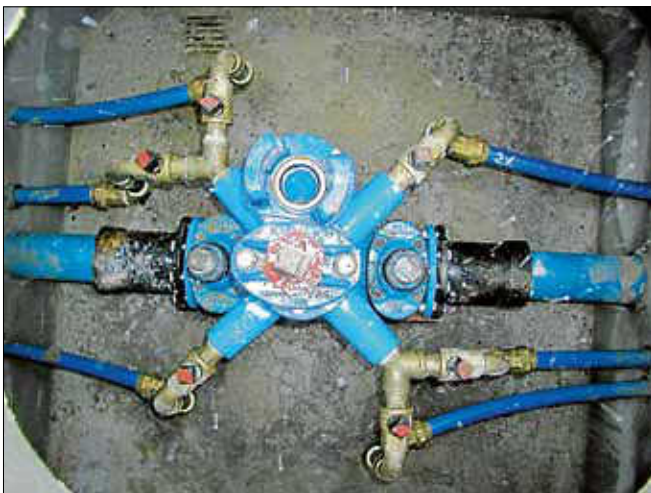
Neue Wasserarmaturen im neuen Schacht in der Pforzheimer Straße. Die größere Leitung ist die Hauptleitung, die kleineren Leitungen sind die Hausanschlüsse.
